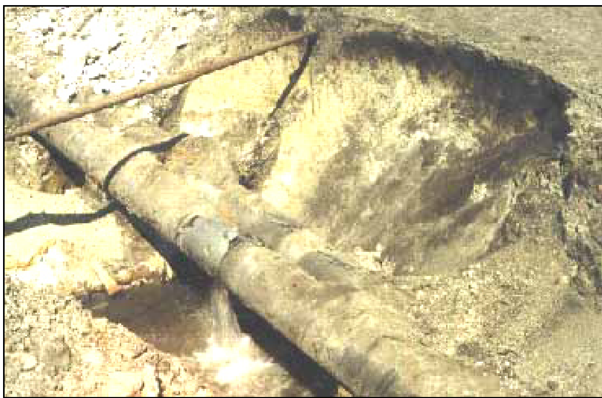
Рис. 4.13. Техногенно-карстовые провалы по трассе канализационного коллектора (дачный массив Верхние Дойки, г. Самара)
